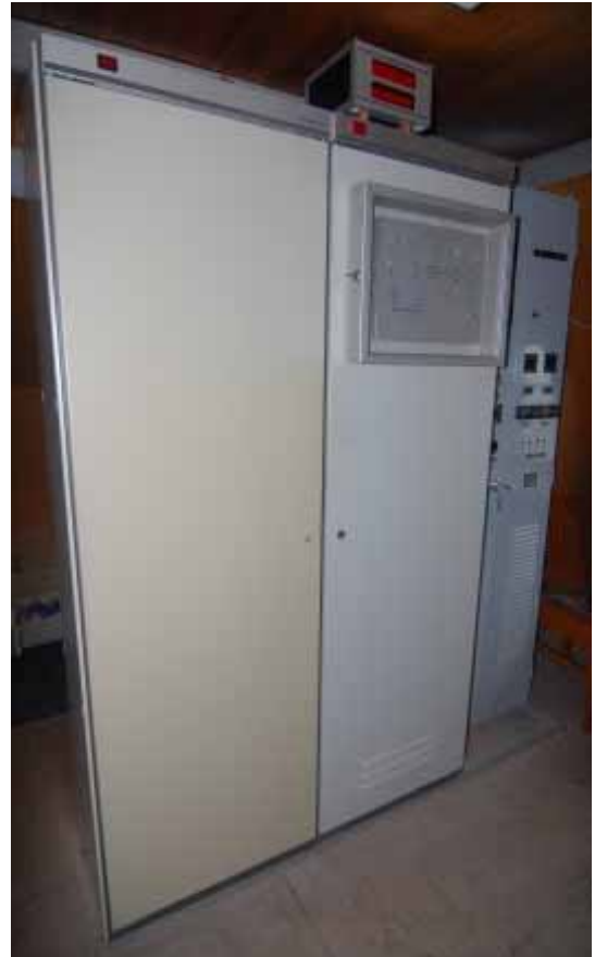
Rechts und vorige Seite: Schaltschränke im Wachraum
