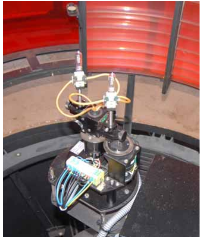
Lampenwechseleinrichtung vor Übergabe des Leuchtfuers vom Bund an die HPA (bis 2014) mit zwei Halogenlampen.
