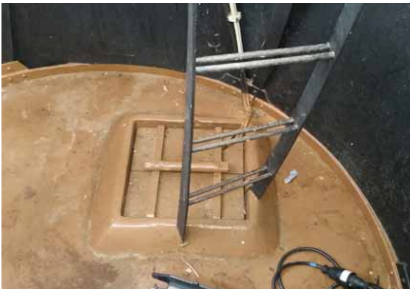
Mannloch im Boden der Betriebsebene
