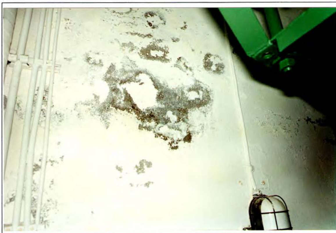
Bild 56: Feuchteschaden im außenliegenden Treppenhaus
