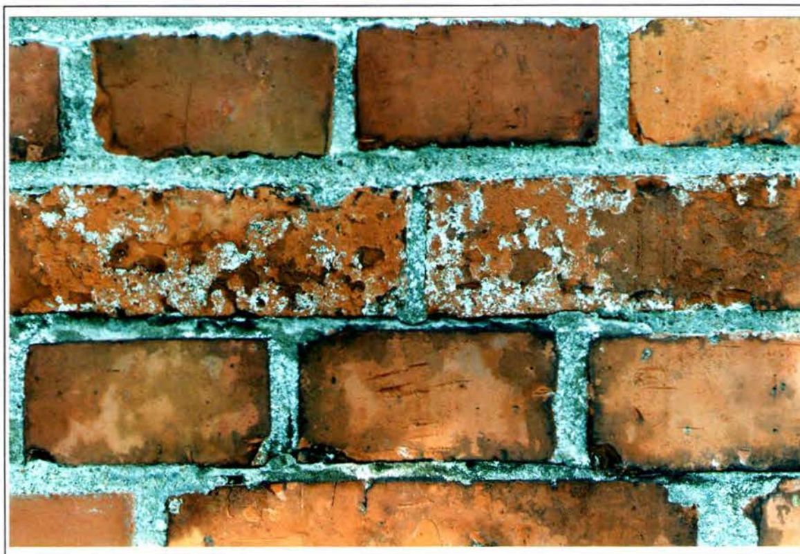
Bild 24: Ausblühungen und geschädigte Brennhaut der Ziegel, Westfassade
