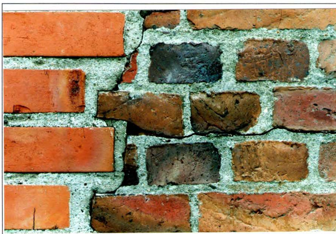
Bild 15: Risse im Mauerwerk im oberen Abschnitt der Südfassade
