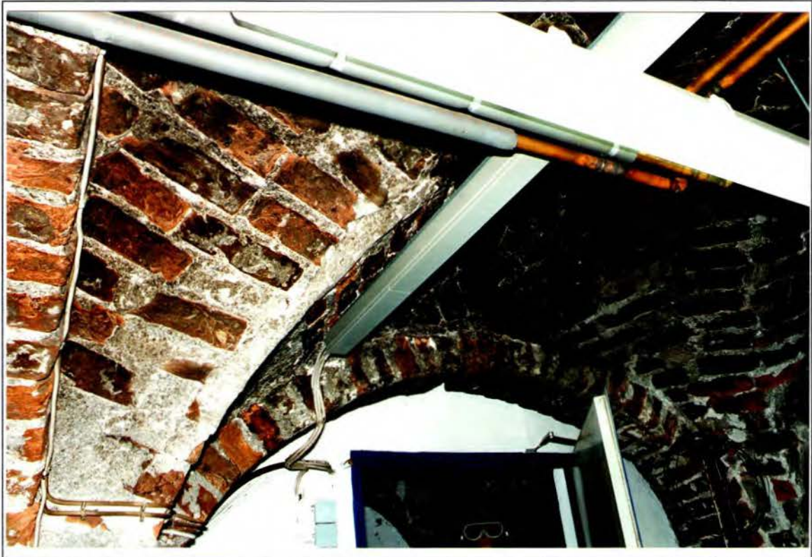
Bild 60: Feuchteschäden im Kellergewölbe
