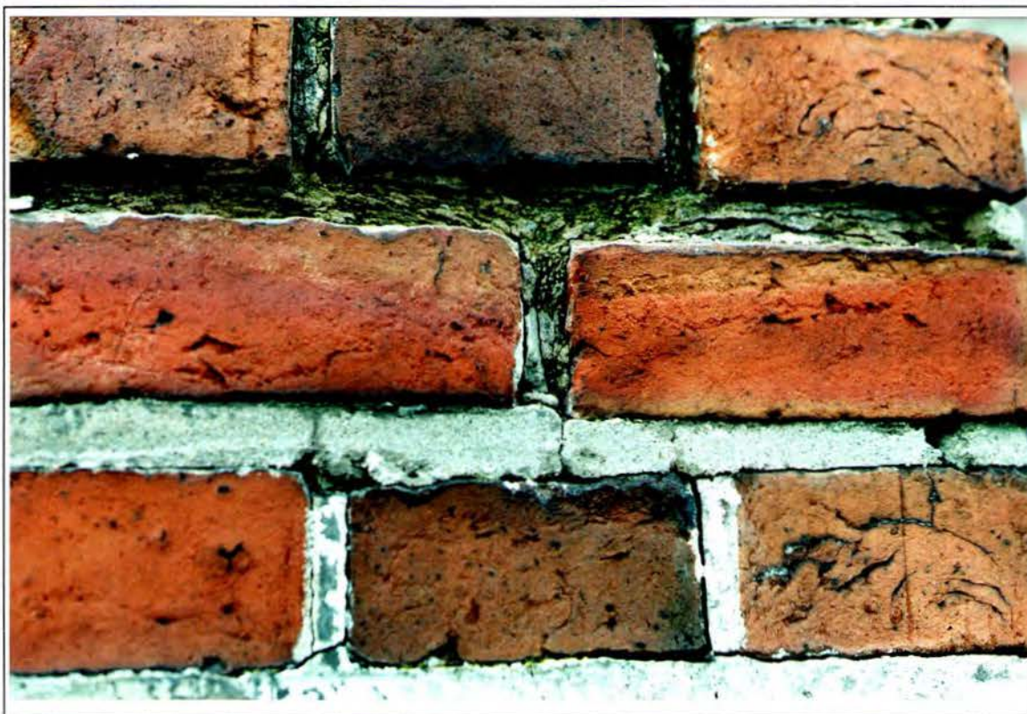
Bild 47: Zerstörtes Fugennetz auf der Ostfassade
