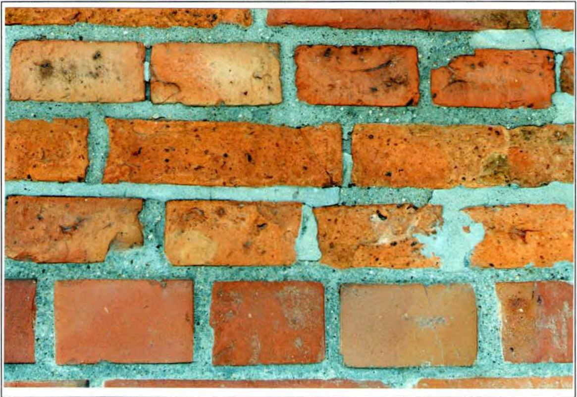
Bild 43: Geschädigtes altes Mauerwerk auf der Ostfassade
