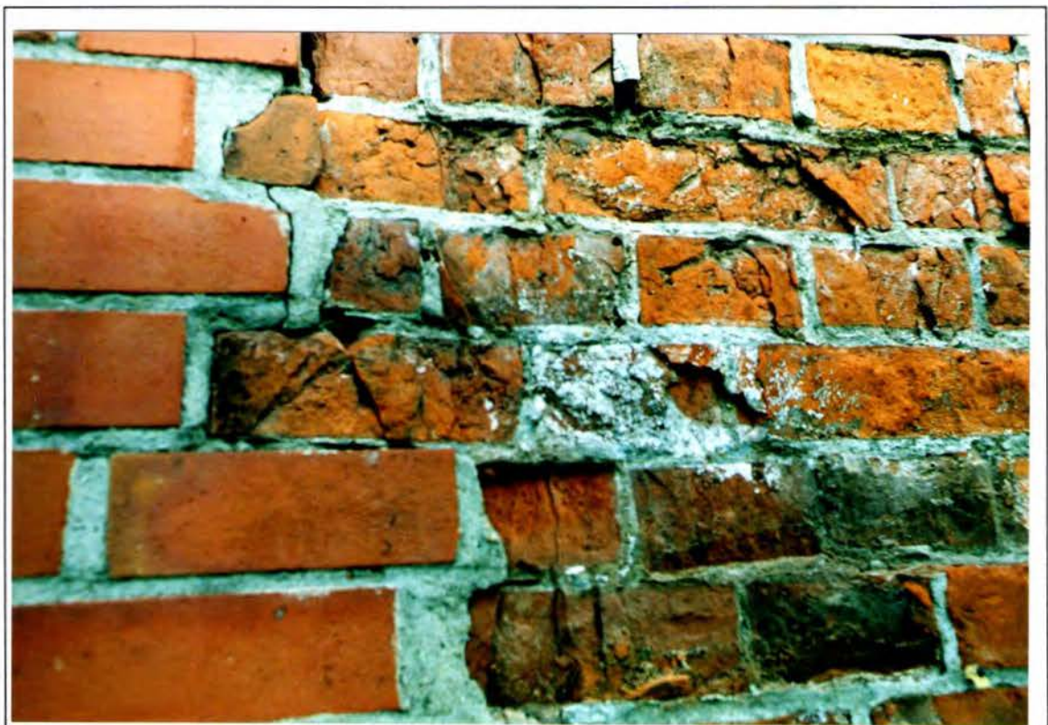
Bild 13: Ausblühungen und Salzkristalle hinter der abgelösten Oberfläche
