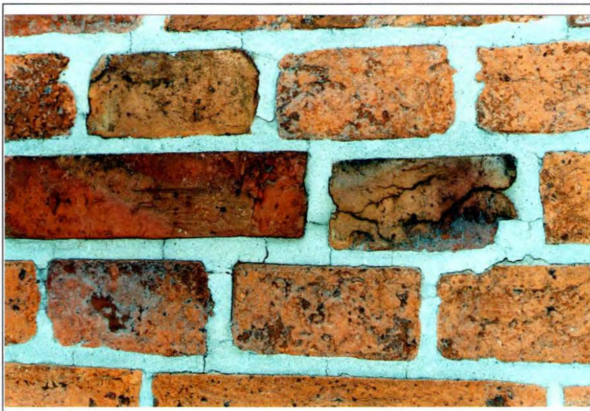
Bild 45: Querrisse im Fugennetz, Ostfassade
