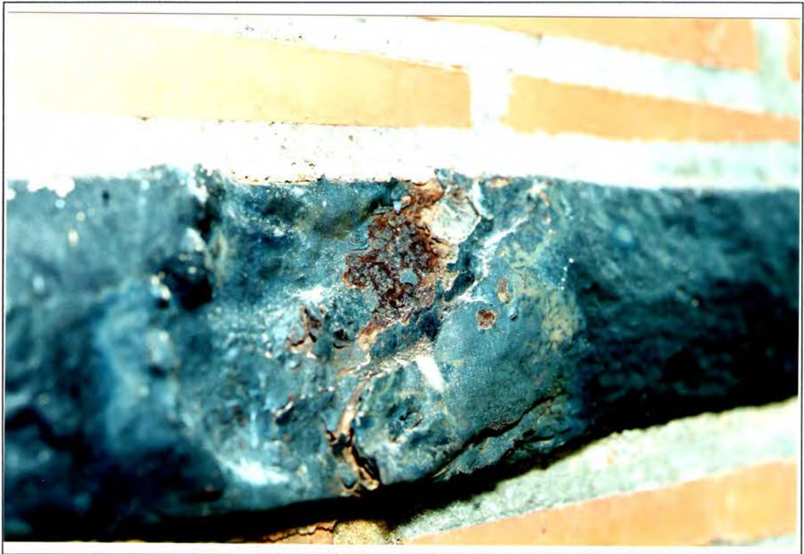
Bild 58: Durch Korrosion geschädigter Anker
