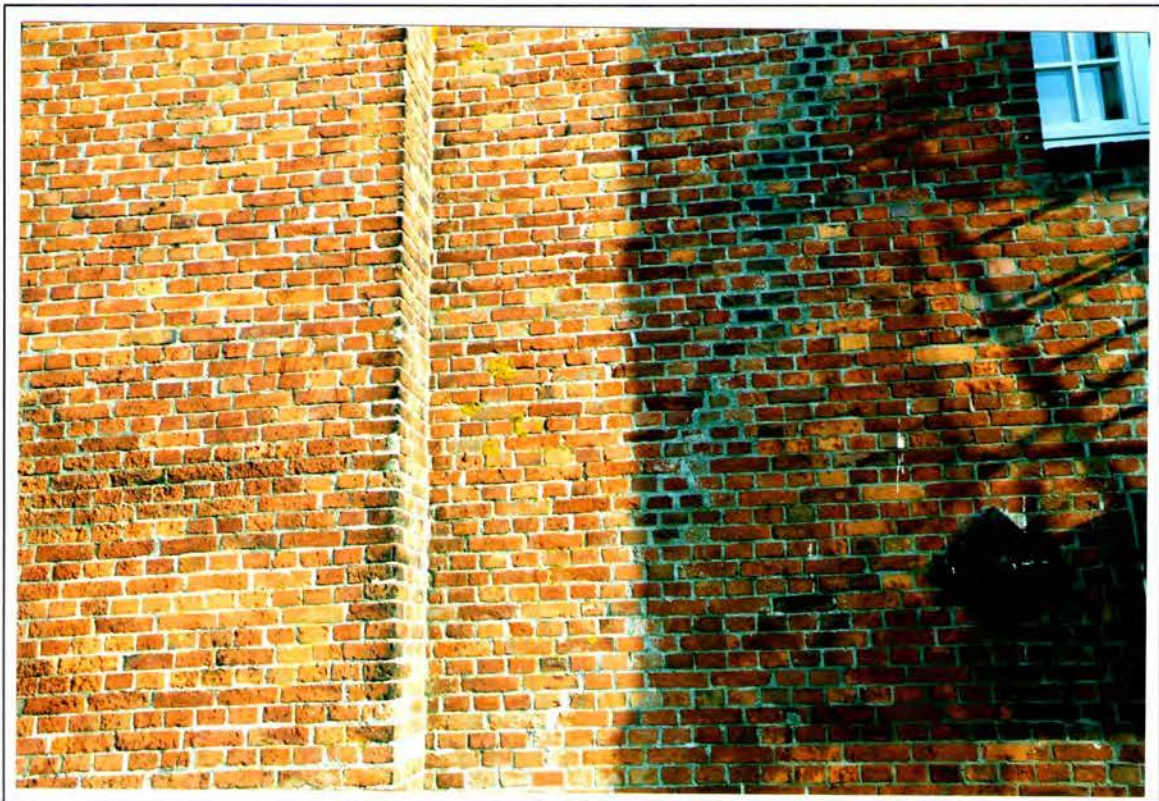
Bild 26: Geschädigte Ziegeloberfläche im linken unteren Bereich der Westfassade
