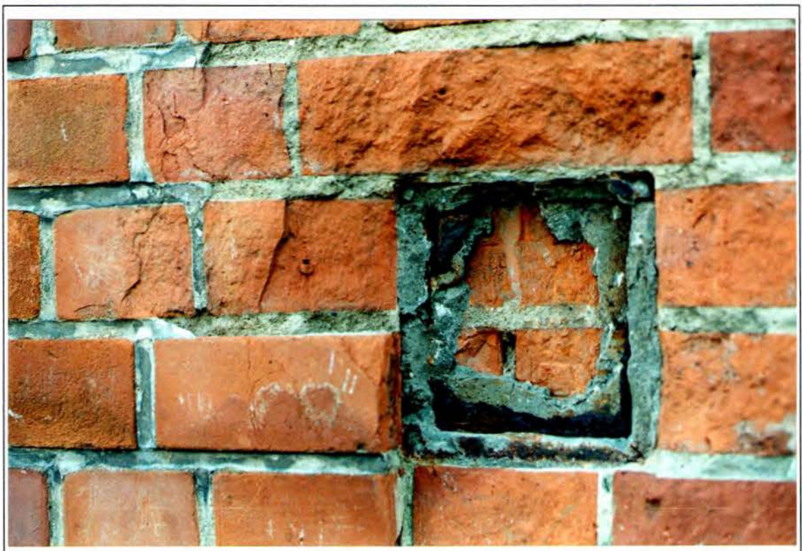
Bild 38: Fehlstelle in der Außenwand des Treppenhauses, Nordfassade
