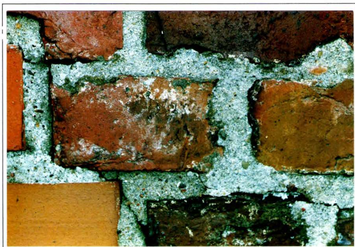
Bild 17: Dito, geschädigtes Fugennetz
