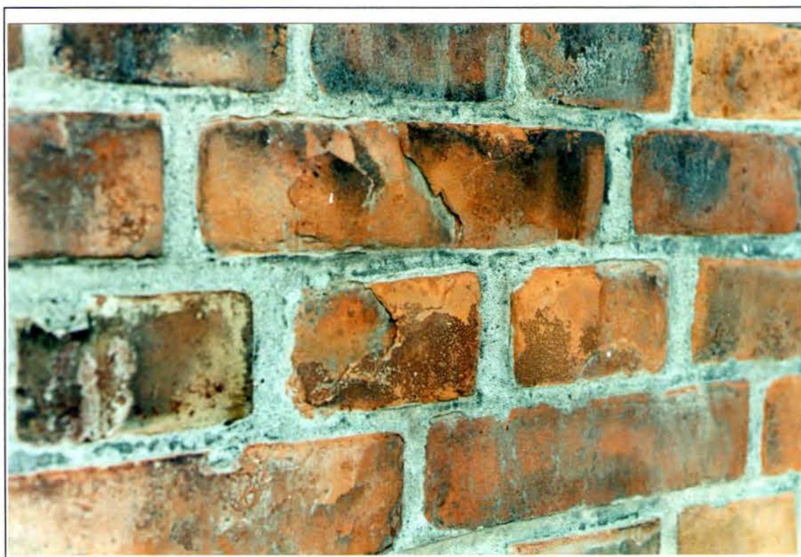
Bild 42: Schalenförmige Abplatzungen der Steinoberfläche, Ostfassade
