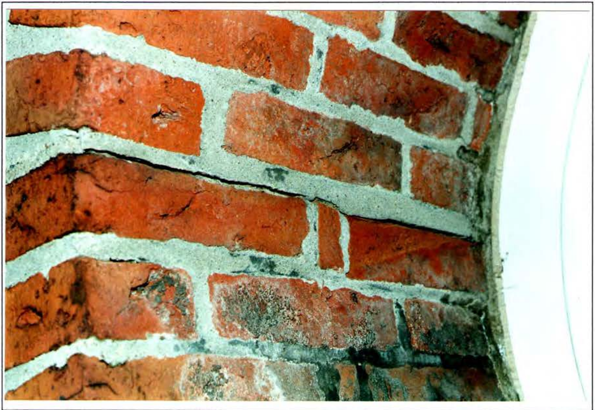
Bild 20: Riß im Fenstersturz
