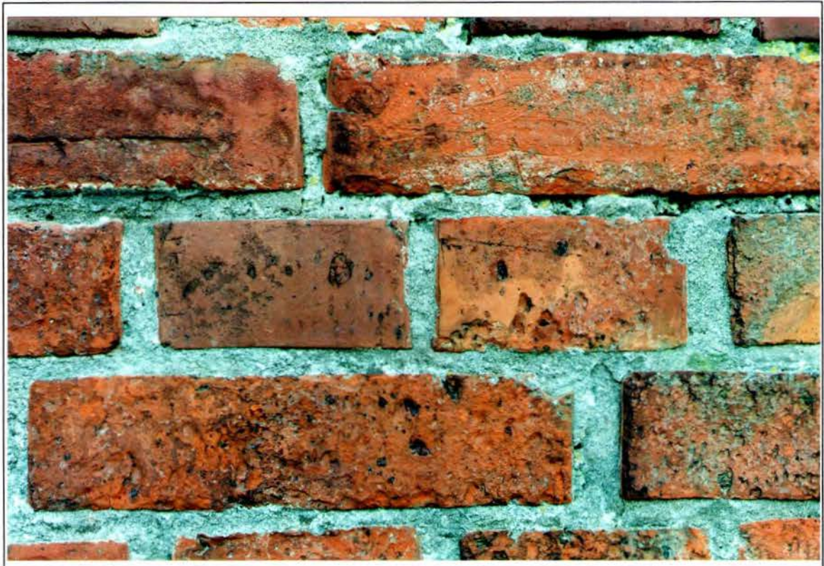
Bild 35: Geschädigtes Fugennetz auf der Nordfassade
