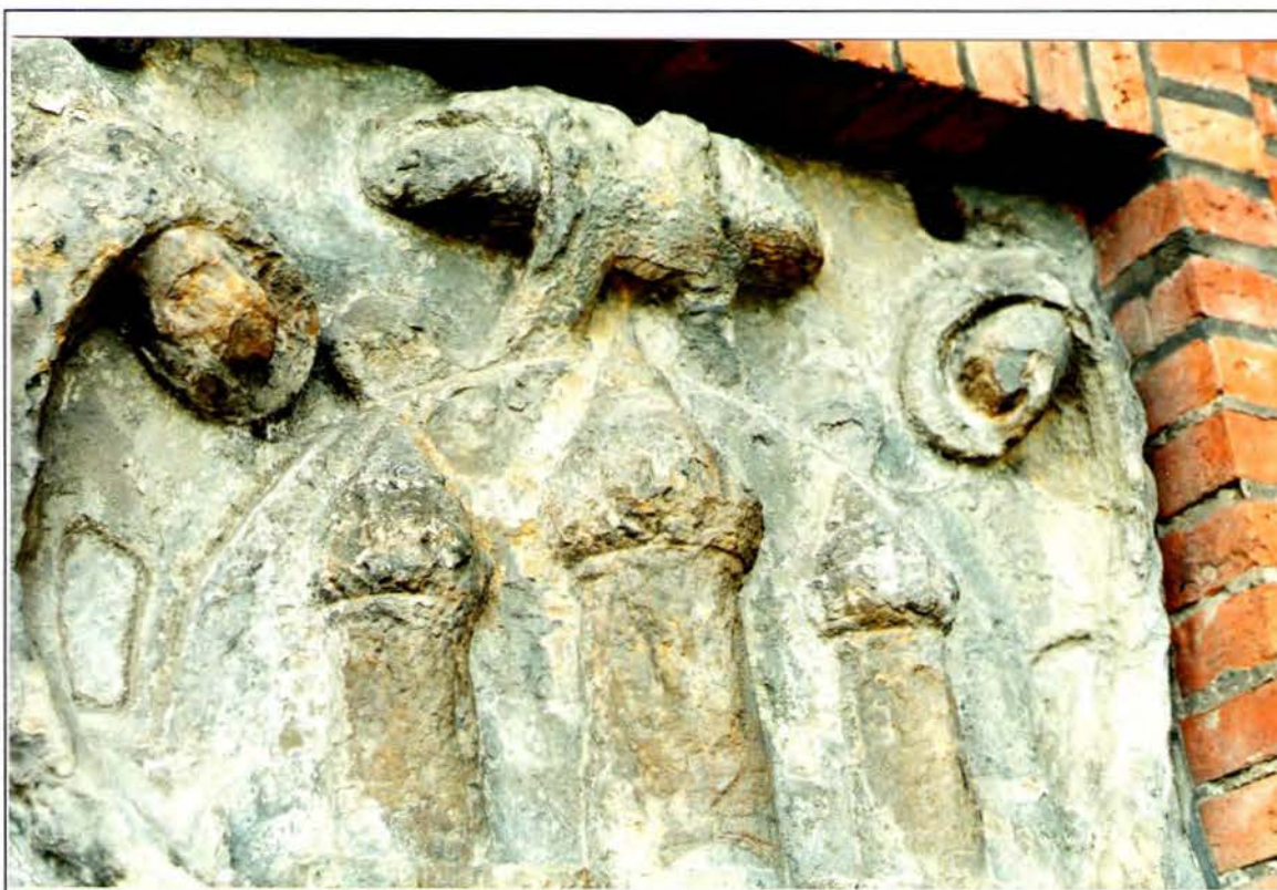
Bild 48: Verwitterung des Natursteins auf der Ostfassade
