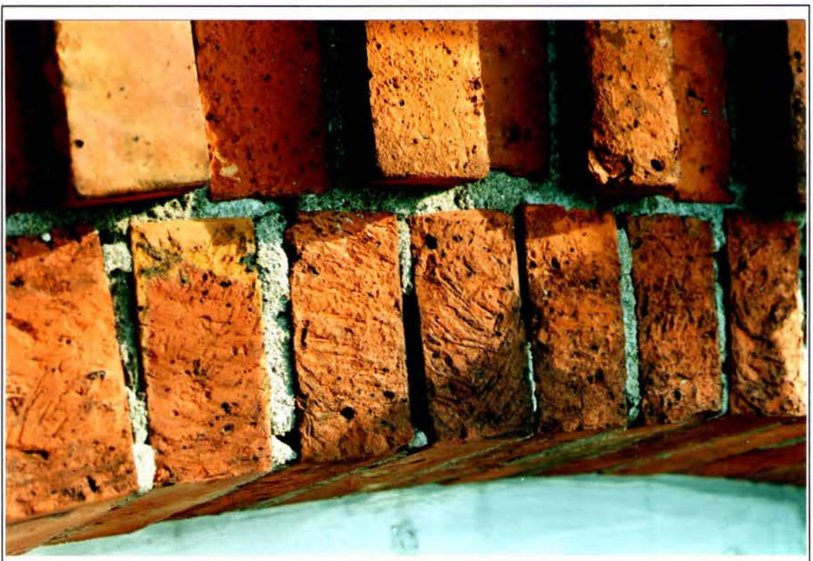
Bild 29: Fenstersturz mit marodem Fugennetz, Westfassade
