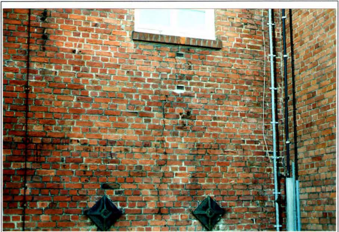
Bild 37: Vertikaler Riß in der linken Hälfte der Nordfassade
