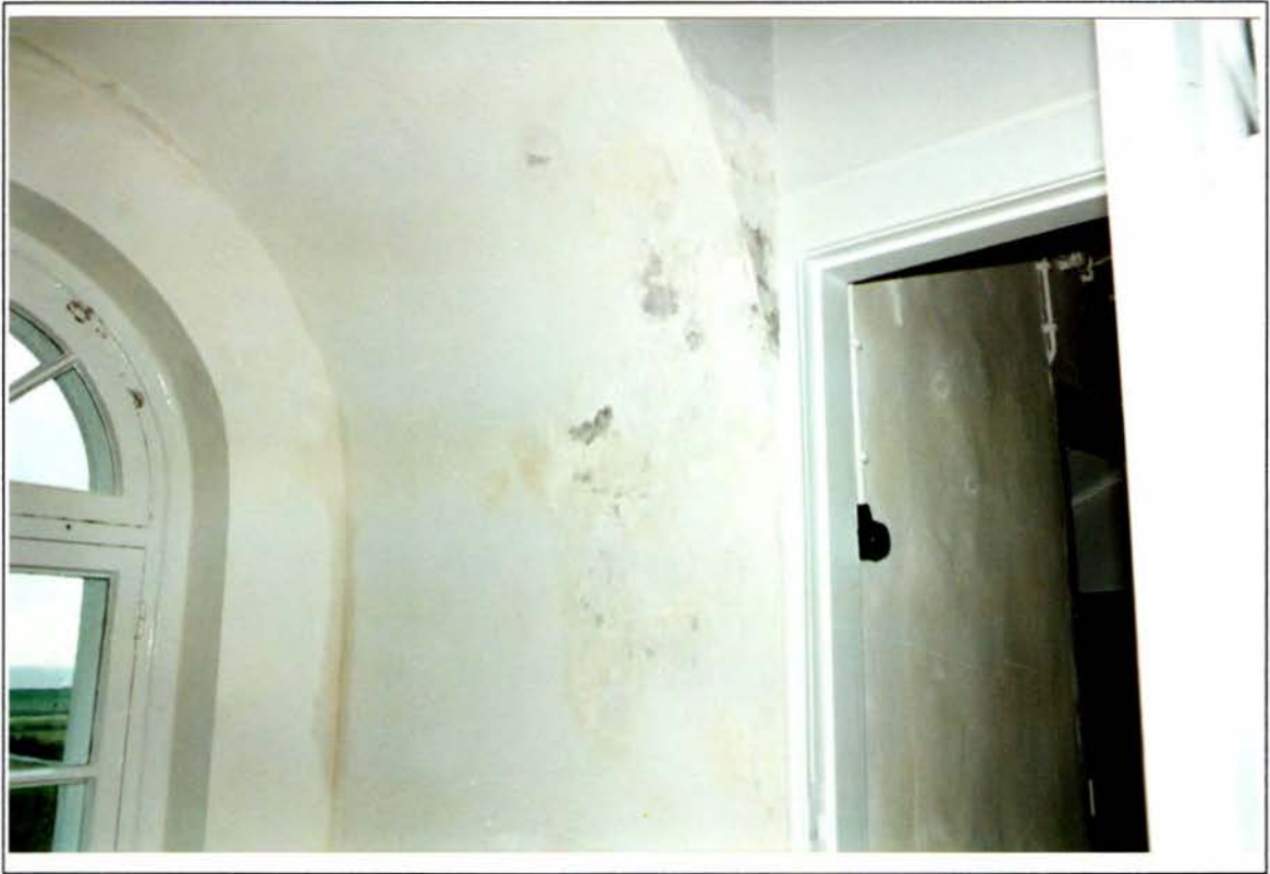
Bild 54: Durchfeuchtungsschäden in einer Fensternische
