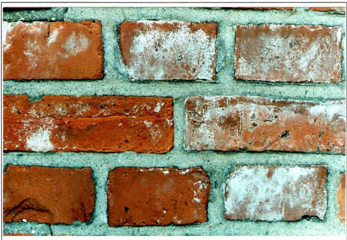
Bild 40: Ausblühungen auf den Ziegeln der Ostfassade
