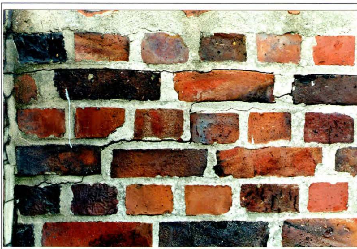
Bild 46: Horizontalrisse in den Fugen im oberen Abschnitt der Ostfassade
