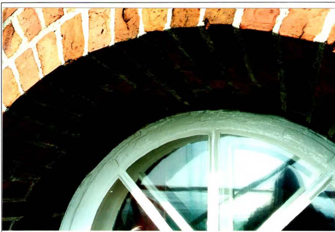
Bild 18: Durchfeuchtungen des Fenstersturzes
