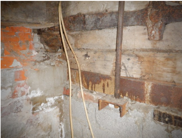
⑥ und ⑦: Bilder 42 und 43: Der Unterzug liegt auf einem Schuh aus Winkelprofilen auf. Das Holz im Wandkontakt ist zerstört. Oben ist jeweils der Wandanker sichtbar
