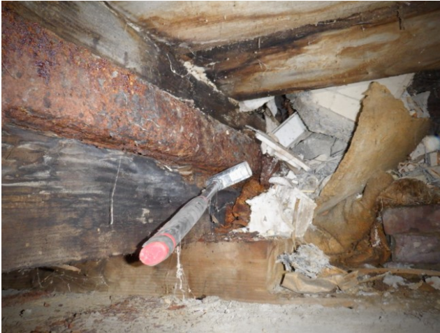
Bild 40: Altschaden. Balkenkopf zerstört.(Hammer!). Bauschutt aus dem Bad darüber wurde deponiert.
