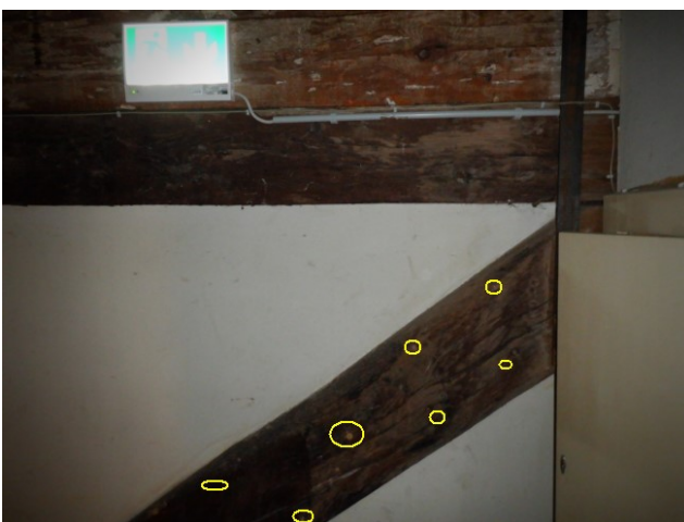
Bild 63 Bohrlochtränkung an Eichenbalken am Ausgang zur Ebene 8.
