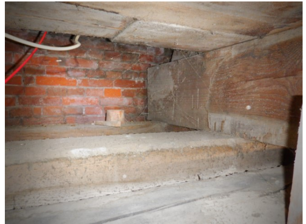
Bild 38 (links): Die Schwelle ist in einer nachträglich erstellten, luftumspülten Mauerwerkstasche auf einem Eichenklotz aufgelegt. (oben: Stichbalken, vergl. Skizze), darunter: Zugbalken mit Maueranker
