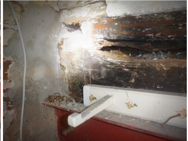
Bild 19: Kopf Süd-West. Altschaden im Holz sichtbar
