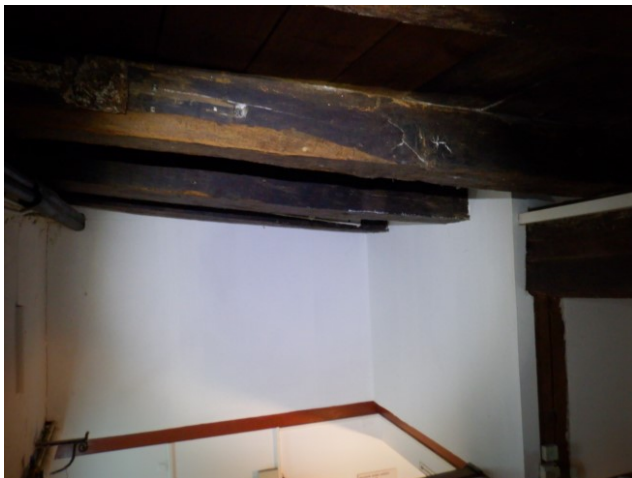
Bild 5: Die Deckenbalken fallen zum Unterzug sehr deutlich ab.
