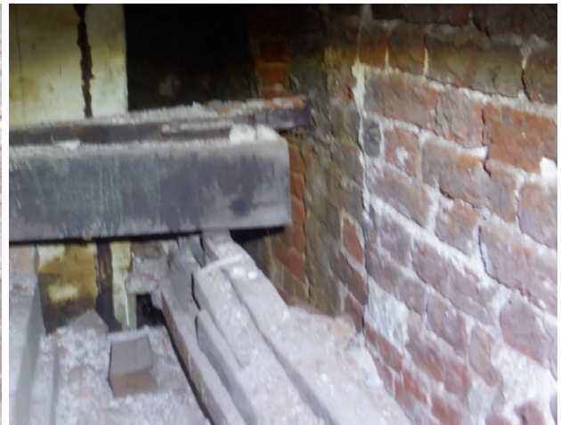
Bild 56: der Balken hängt nur am Mauerwerksanker.
