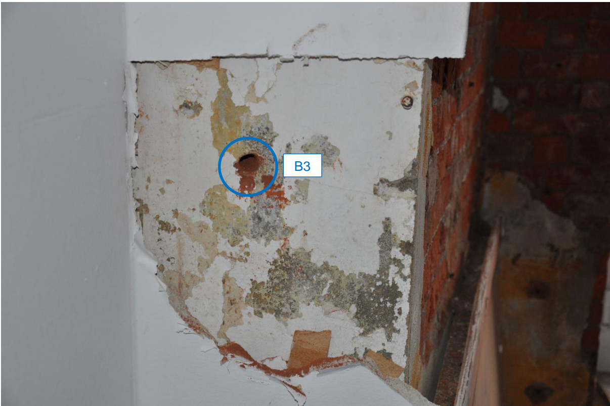
Abb. 36: Entnahmestelle der Bohrmehlprobe B3 (Ebene 3, O-Seite)
