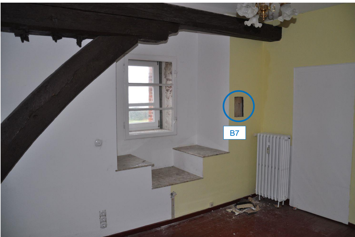
Abb. 45: Entnahmestelle der Bohrmehlprobe B7 (Ebene 5, O-Seite)
