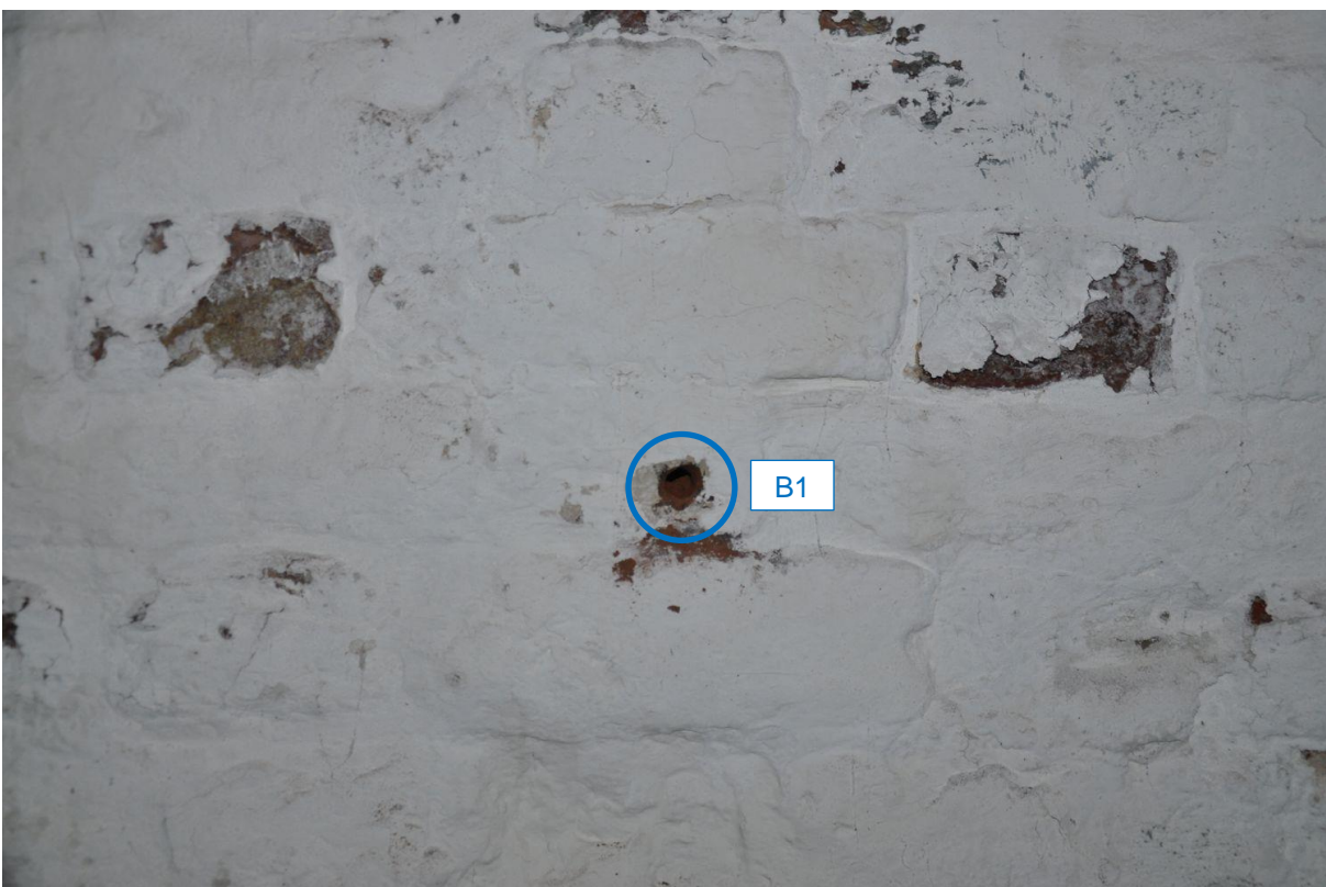
Abb. 29: Entnahmestelle der Bohrmehlprobe B1 (Ebene 1, O-Seite)
