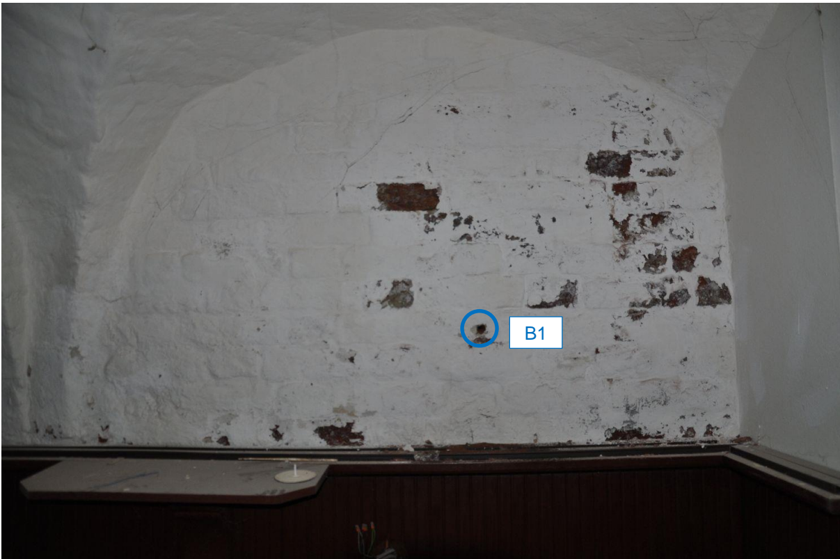
Abb. 28: Entnahmestelle der Bohrmehlprobe B1 (Ebene 1, O-Seite)
